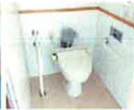
トイレ ハリアフリータイプ。背もたれ、手すり完備
